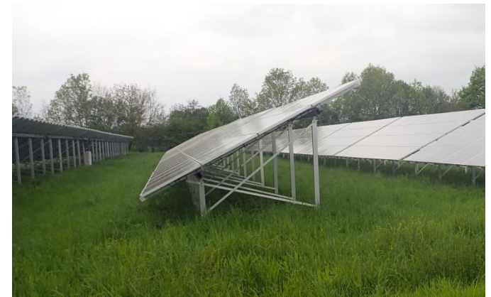
Foto: PV-Anlage Neuching © Planungsverband Äußerer Wirtschaftsraum München (PV)
